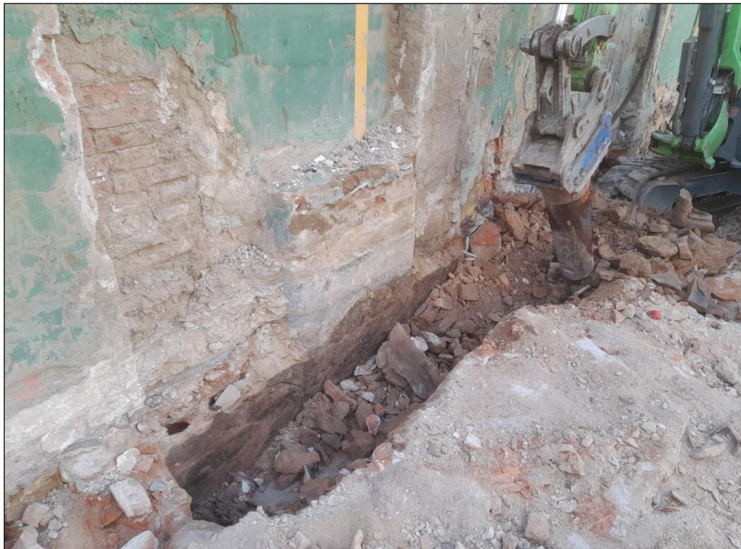
Figura 7. Tram de la primera rasa. La màquina ha de picar antics fonaments.
