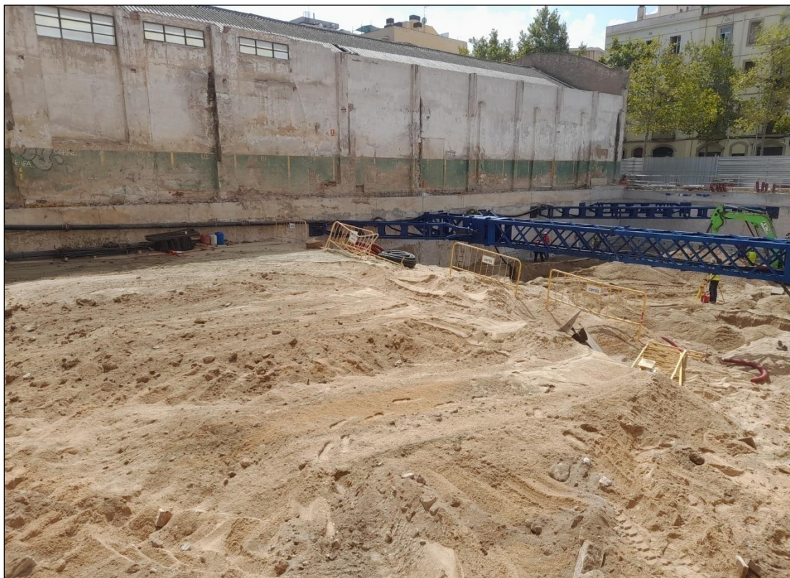
Figura 27. El solar un cop extretes les basses i terra contaminada. S'observen només sorres.
