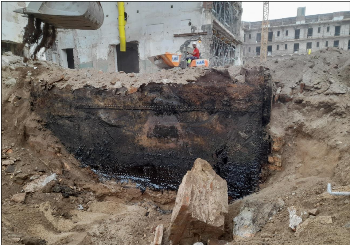
Figura 26. La bassa 1 al destapar-se durant el rebaix, s'observa com la carcassa és recoberta d'un fuel espès.
